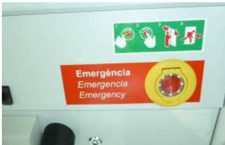
Figura 26. Pulsadores de emergencia
